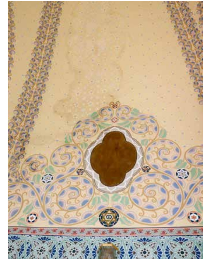
Abb. 2 Kuppelsegment mit großflächigen Verfärbungen und geschwächter Malschicht durch Feuchteintritt
